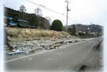
(東日本大震災擁壁崩落)
