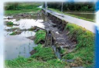
(令和元年東日本豪雨町道被災)
