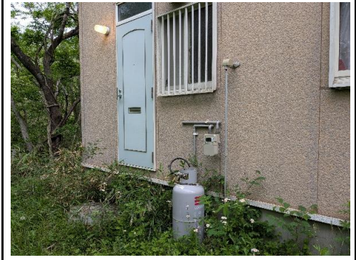
勝手口・ガス
