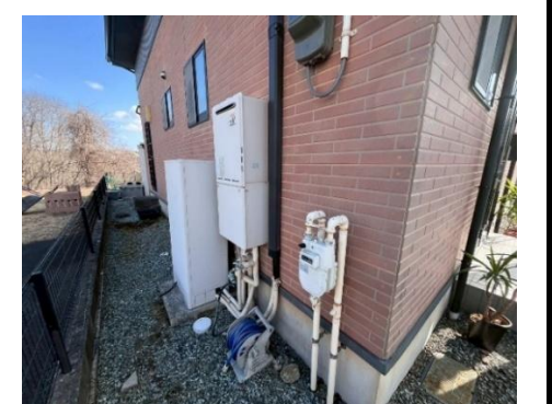
ガスメーター
